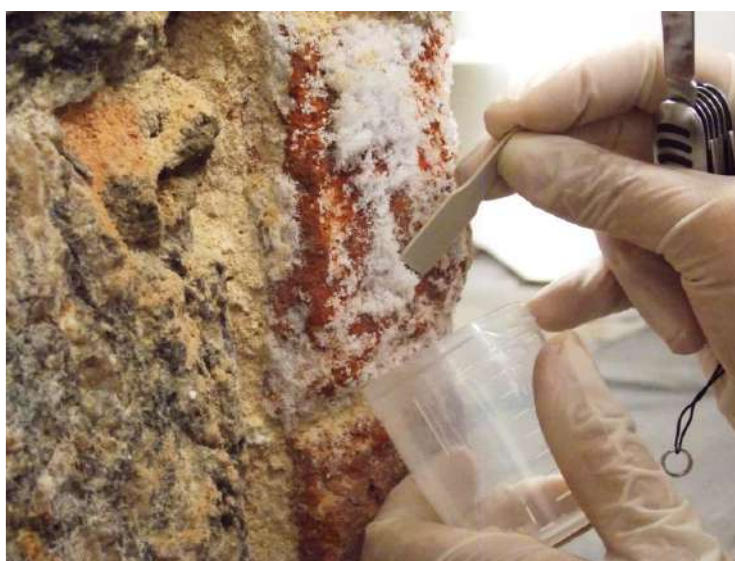
Figura 1. Coleta de amostras de eflorescência provenientes da pilastra estudada no salão Del Rey do Paço Imperial. Foto: Emílio Velloso Barroso, julho de 2014.
