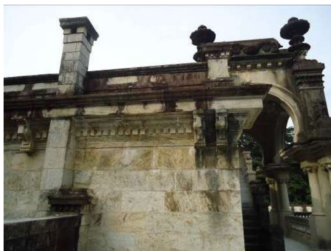
Figura 3: Escamação da rocha na face oeste.
